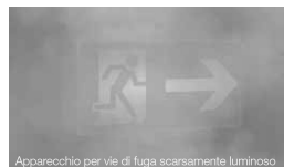
Apparecchio per vie di fuga scarsamente luminoso.
